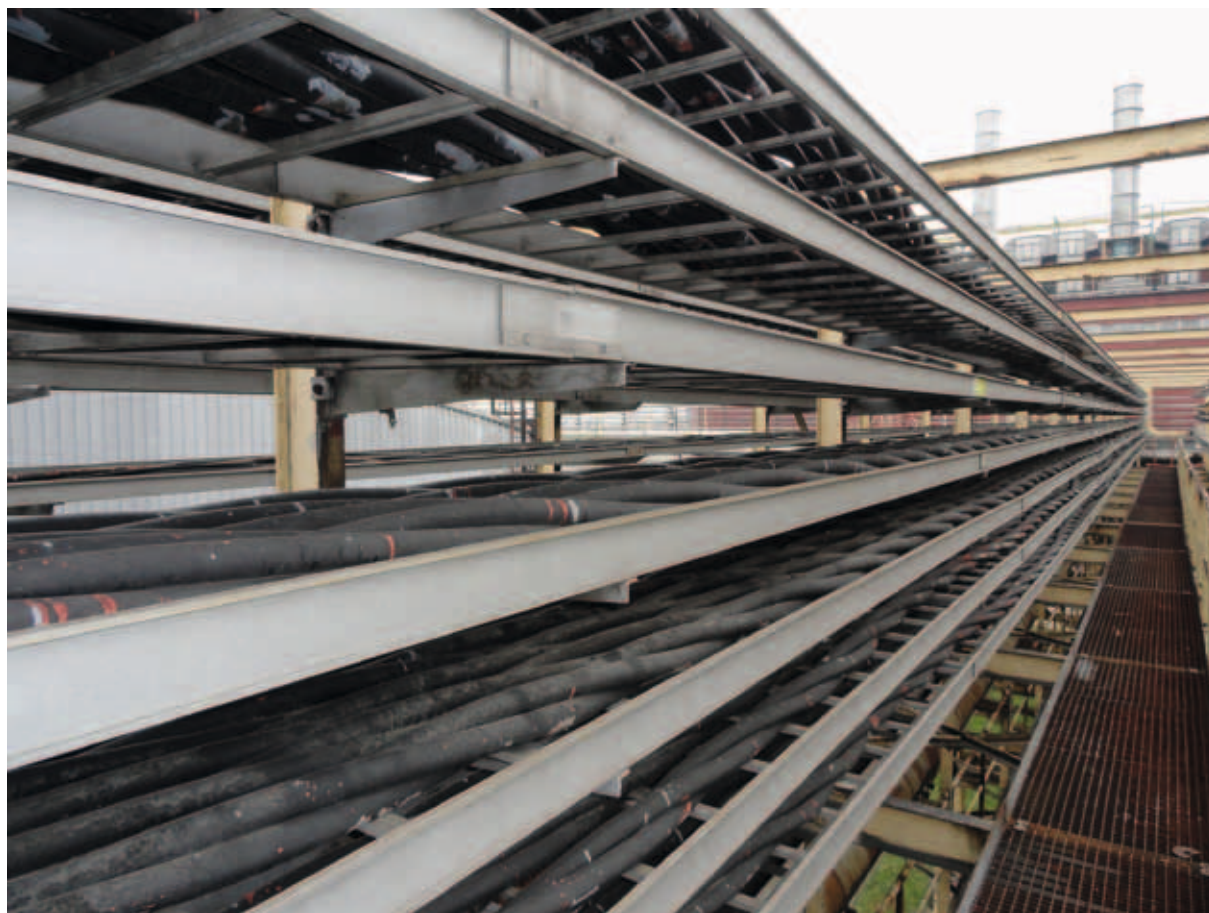
Kabelové lávky s kabely 10 kV po 20letém provozu s pozinkovanými natřenými výložníky
