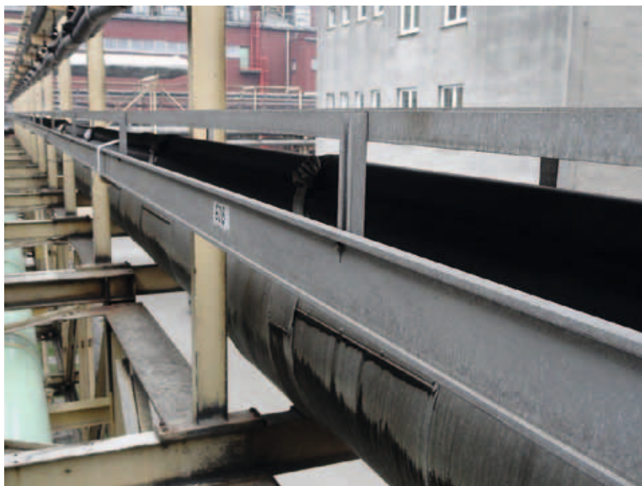
Hliníkový kabelový most s protipožárními přepážkami pro 110 kV kabel
